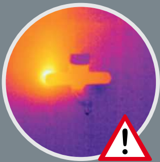
Mischarmatur angebunden über Doppelwandscheiben. (Temperatur > 60° C)
